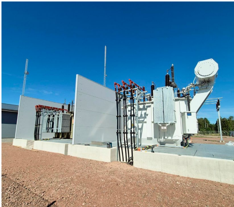
Kuvassa Mussalon sähköaseman vuonna 2025 käyttöön otettu toinen päämuuntaja.
