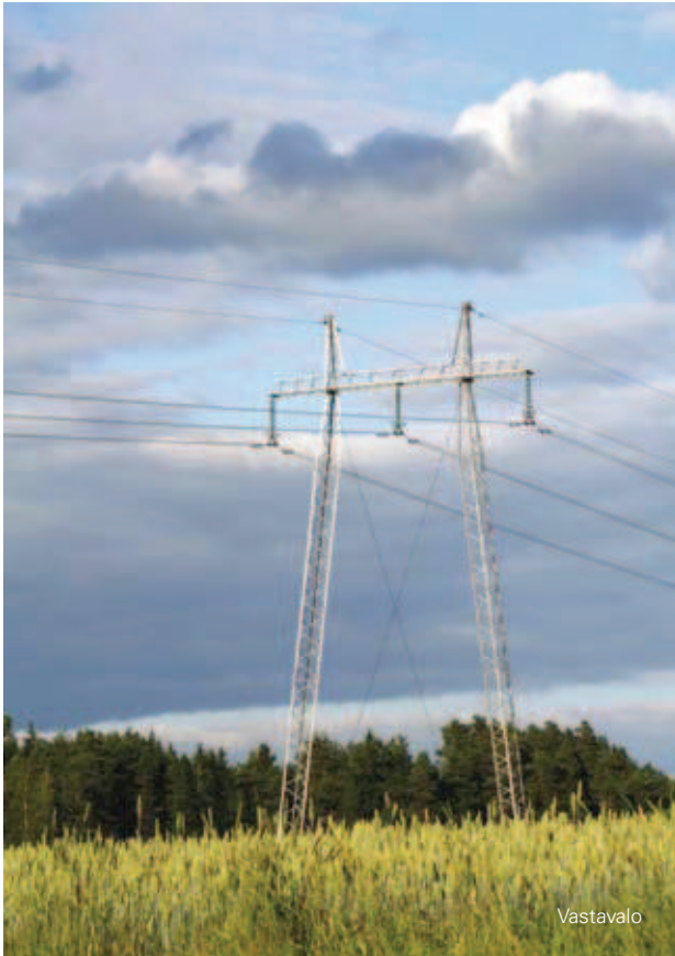
Suomessa yleisin pylvästyppi on harustettu eli vaijerilla tuettu portaalipylväs, jossa kulkee kolme johdinta rinnakkain ja näiden yläpuolella on yleensä kaksi ukkosjohdinta.
